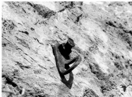
Fig. 11a, b, c - Deterioramenti evidenti da fenomeni di corrosione, ma altri errori di piazzamento sono altrettanto pericolosi
